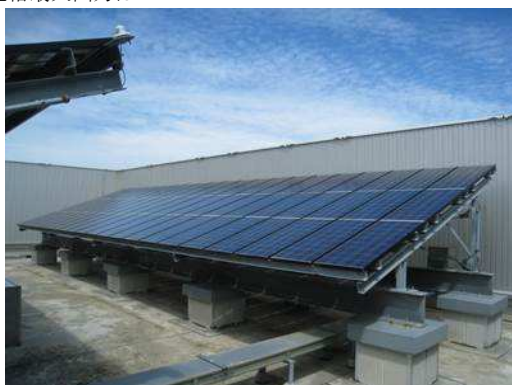
太陽光発電設備（防災センター屋上）
